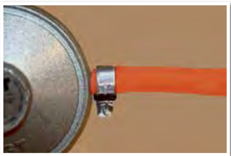
Slanganslutning vid reducerventil
